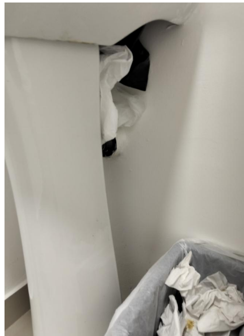
Lava manos con desagüe dañado,
